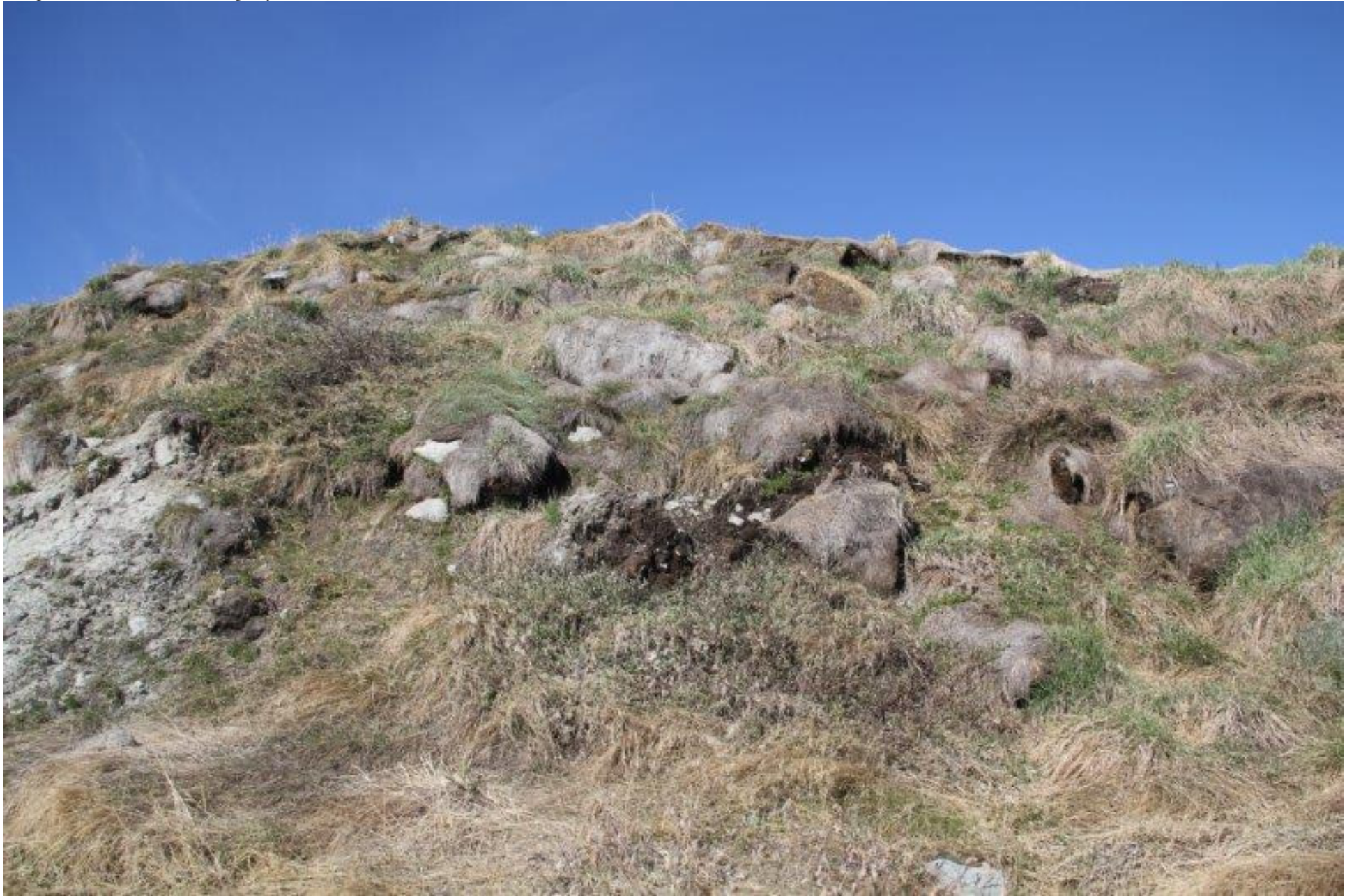
Fig. 2-7. Erosion af den sydlige del af kystskrænt A.
